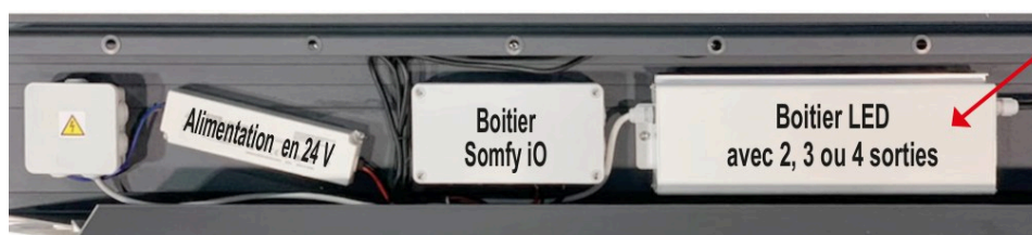
Figure 56 – Dans le cadre : le boîtier de raccordement, l'alimentation 24 V, le boîtier Somfy et le boîtier des LED
